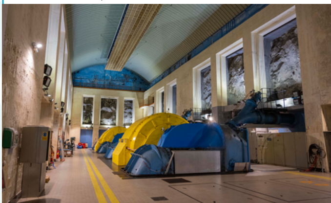
↑ Interieur de l'usine de Montpezat
